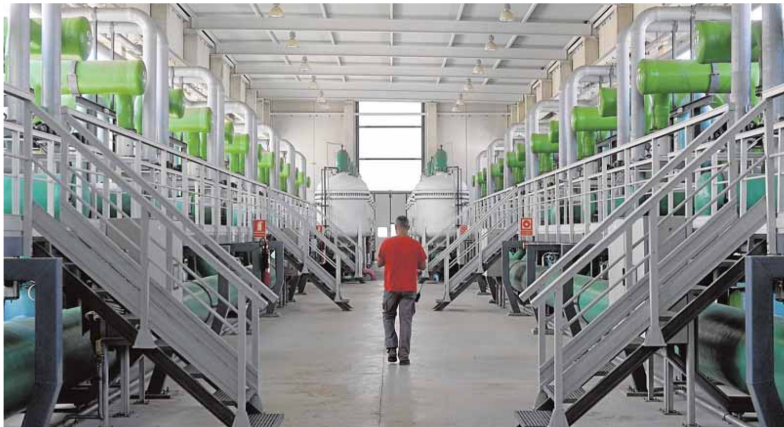
Tanques de filtrado de agua en la desaladora de Torrevieja, que será la más grande de Europa. :: NACHO GARCÍA / AGM
