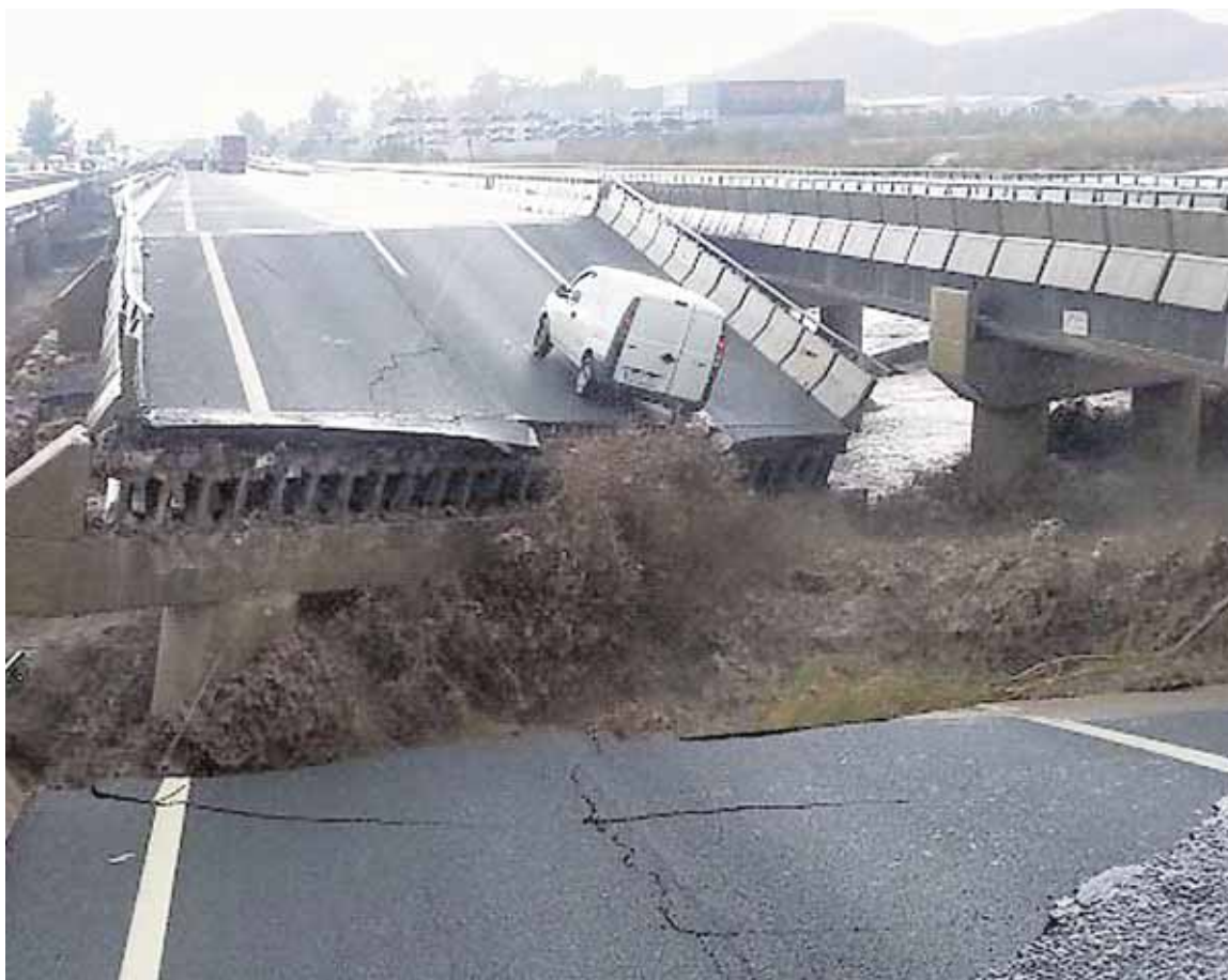
La fuerza del agua destruyó una parte de la autovía A7, entre Lorca y Puerto Lumbreras el 28 de septiembre de 2012. Los cimientos cedieron en el tramo más antiguo. ■ ANTONIO YEPES
